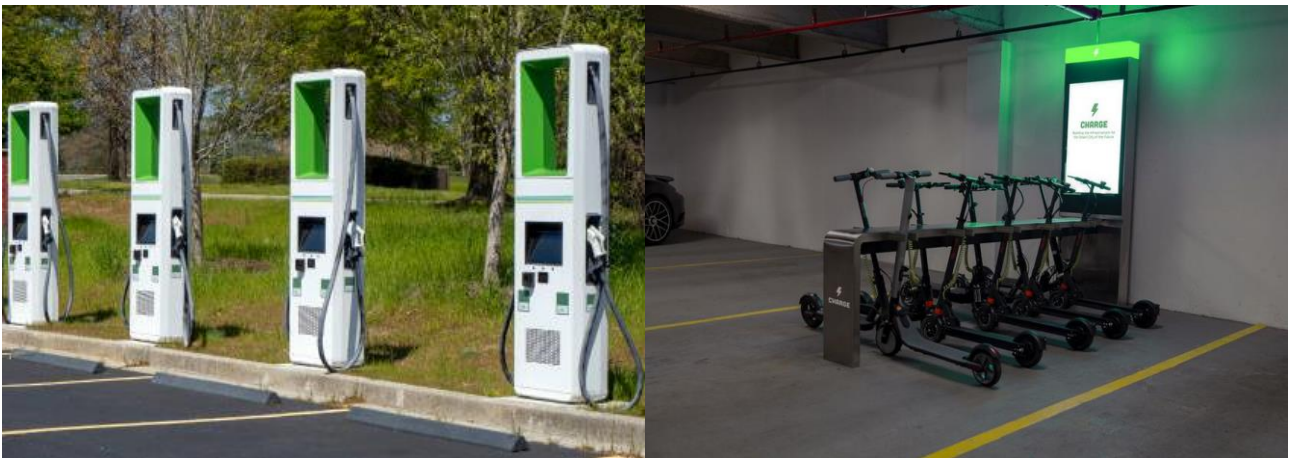
Joonis 5.18. Elektriautode laadijad 118
