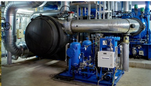
Joonis 5.21. Katri Vala kaugkütte- ja jahutusjaama soojuspump 128
